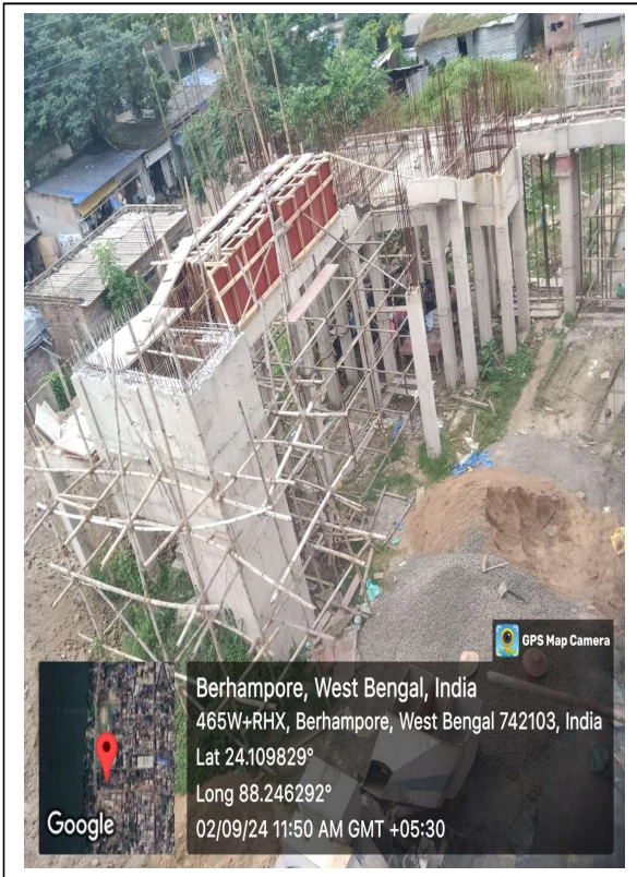
BEHARAMPORE STP SITE
