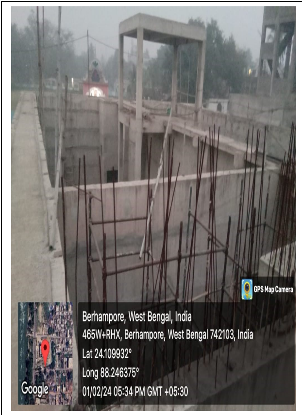
BEHARAMPORE STP SITE
